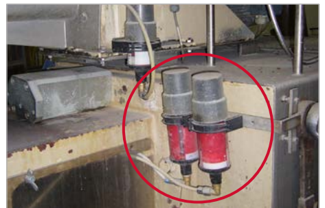
Schmierung eines Stehagers der Um- lenkrolle mittels entfernter Montage
