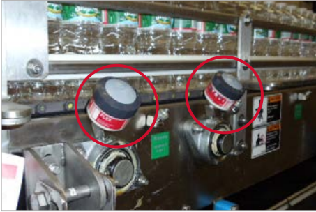
Schmierung eines Förderbandflansch- lagers an einer Abfüllanlage
