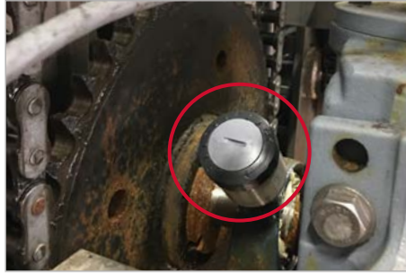
Schmierung eines Stehagers an einer Antriebstrommel
