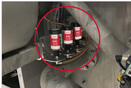
Schmierung der Stehlager an einer Bandwaage mit entfernter Montage
