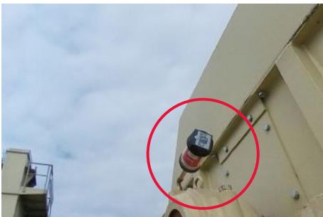
Stehlagerschmierung am RA-Elevator
