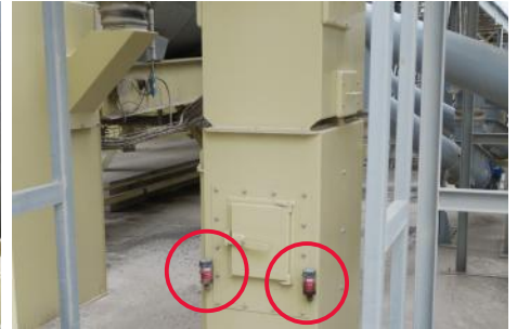
Fußlagerschmierung am Füllerelevator
