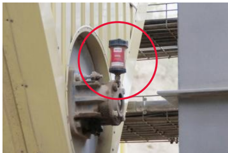
Flanschlagerschmierung an der Trogschnecke Entstaubung
