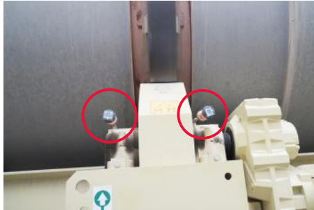
Schmierung von Druckrollenlagern an der Trockentrommel
