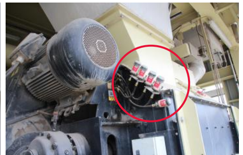
Mischerklappen- und Mischerwellenschmierung
