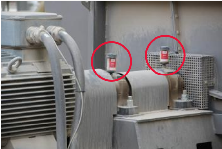
Stehlagerschmierung am Exhaustor
