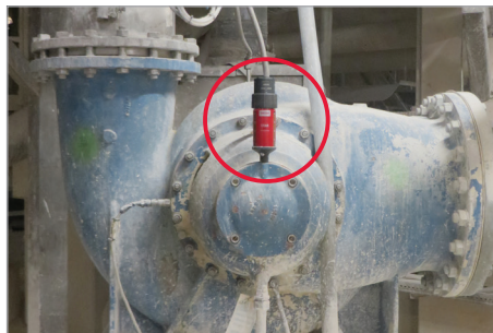
Lagerschmierung der Pumpe
