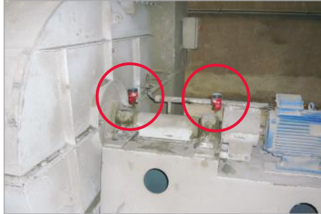
Stehlagerschmierung der Lüfterwelle
