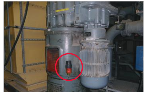
Wälzlagerschmierung am Rührwerk
