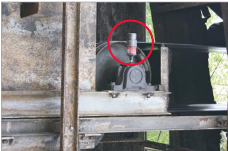
Wellenlagerung an der Förderbandtrommel
