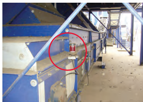
Flanschlagerschmierung einer Förderbandanlage
