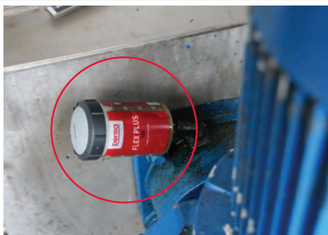
Lagerschmierung einer Pumpe
