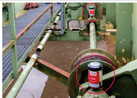
Wälzlagerschmierung am Räumler
