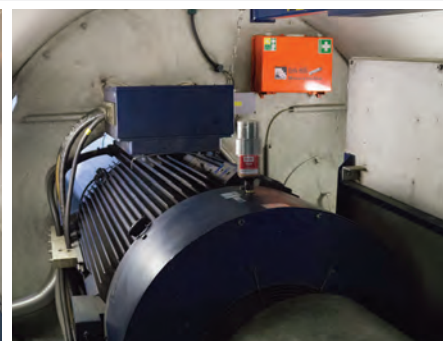
Automatische Nachschmierung der Generatorenlager
