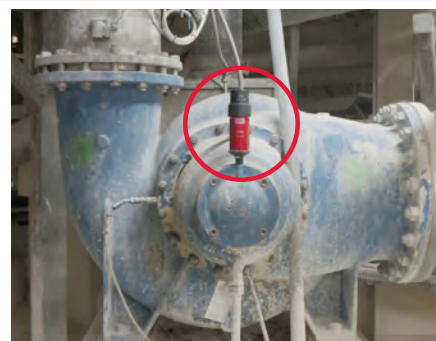
Lagerschmierung einer Pumpe
