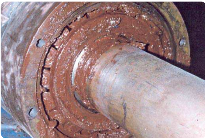
Kegelrollenlager in einer Pumpeneinheit Dichtungsversagen, Lagerkorrosion und rötlich verfärbtes Schmierfett
